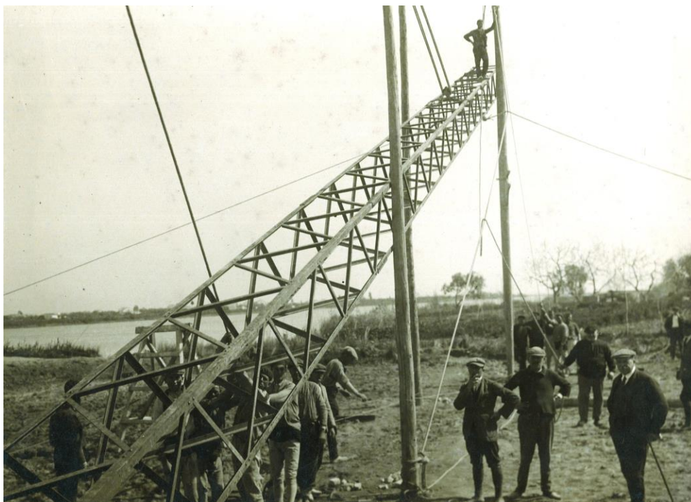
Instal·lacions de la Eléctrica del Ebro Fons Antoni Cartes Reverté
